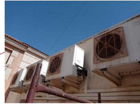
FOTO 3- EQUIPOS 2. TERRAZA INTERIOR.
