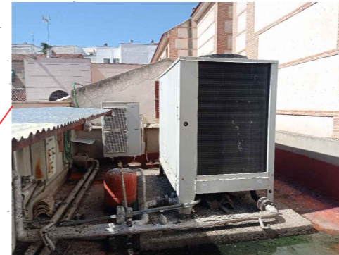
FOTO 5- EQUIPOS 3. TERRAZA INTERIOR.
