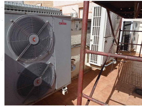
FOTO 4- EQUIPOS 2. TERRAZA INTERIOR.
