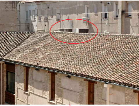
FOTO 1- EQUIPOS 1. CUBIERTA POSTERIOR FOTOGRAFIA DESDE TERRAZA OPUESTA INACCESIBLE AL PÚBLICO
