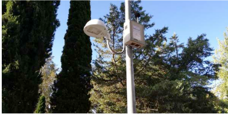
Instalación de un sonómetro para medición de ruido de larga duración.
